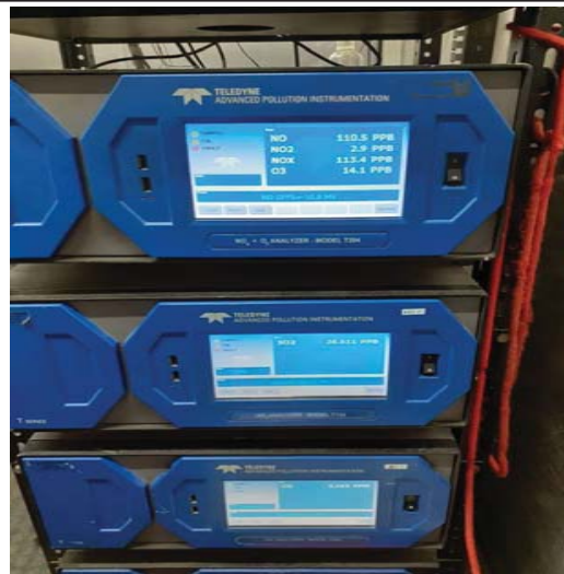
Vista interior de los analizadores de gases
