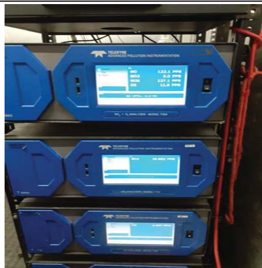
Vista interior de los analizadores de gases
