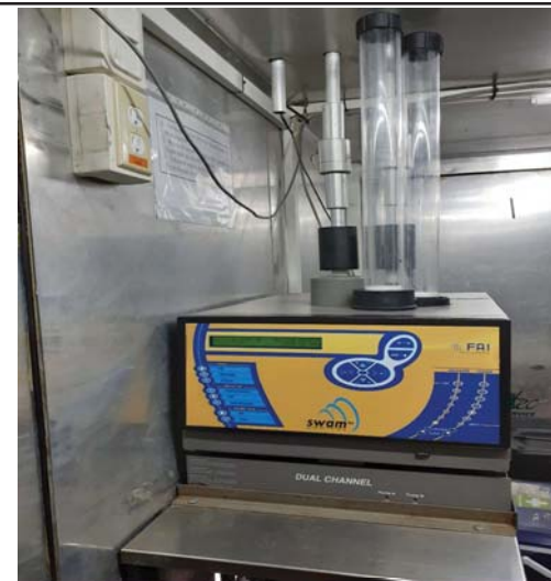
Vista interior del analizador de material particulado
