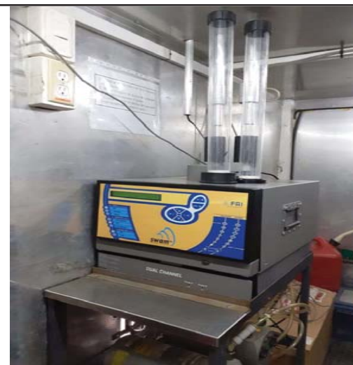
Vista interior del analizador de material particulado
