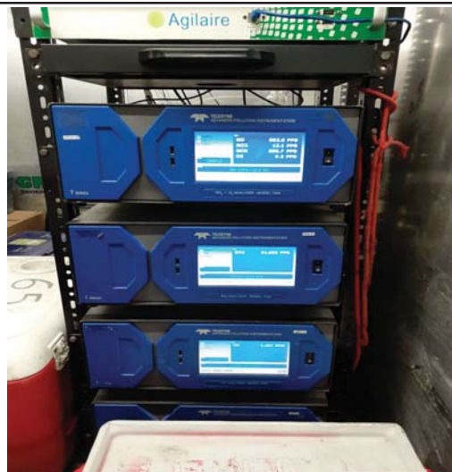
Vista interior de los analizadores de gases
