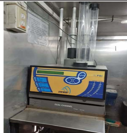
Vista interior del analizador de material particulado
