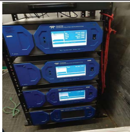
Vista interior de los analizadores de gases
