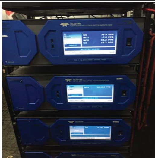
Vista interior de los analizadores de gases
