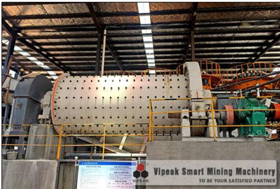
Figura 7-51 Ejemplo de un Molino de Bolas dentro de un Edificio Revestido con Lámina (vista interna)
