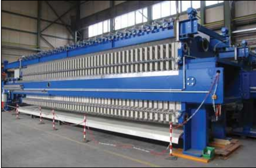
Figura 7-52 Ejemplo de Filtros dentro de un Edificio Revestido con Lámina
