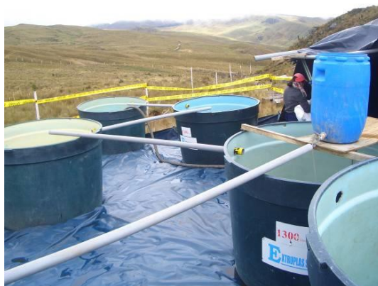
Foto 8.9. Sistema de tratamiento de lodos y ripios de perforación (Foto de archivo)
