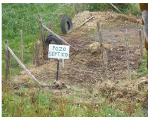
Foto 8.16. Pozo séptico (dormitorios trabajadores – Campamento Base).
